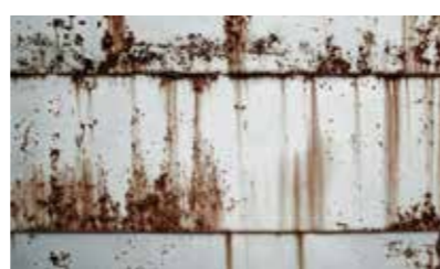
Beschermen tegen roest en corrosie
